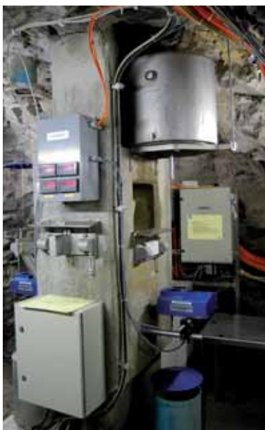
Abb. links: Hochsensible Messanlage im Inneren der Urftalsperre
