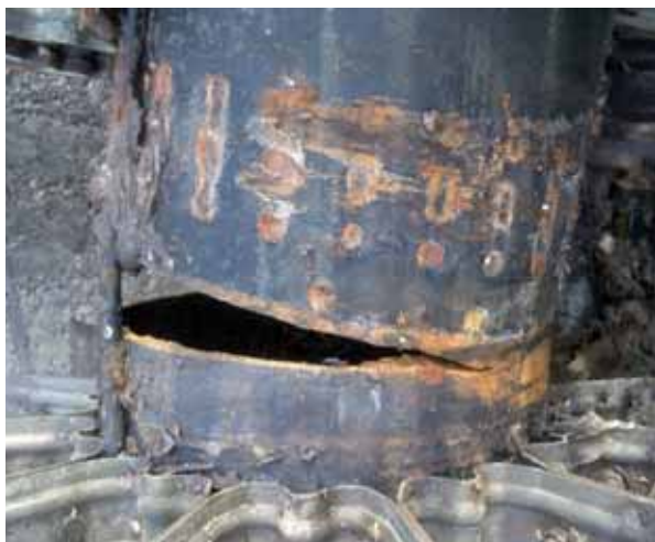
Abb. links: Bruchstelle in der Rohr- welle der Belüfter- walze auf der Kläranlage Roetgen
