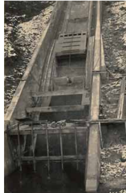
Abb. links: Schieberbahn mit Rollschütz in hochgezoge- ner Position am Damm der Rurtal- sperre Schwam- menauel
