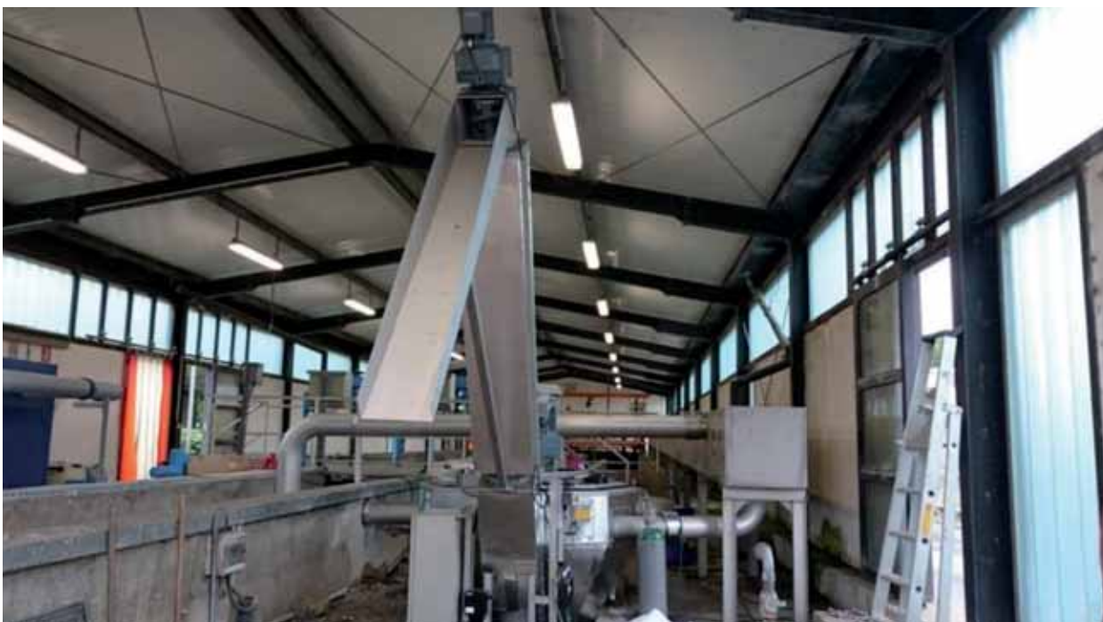
Neuer Sand- waschklassierer auf der Kläranlage Stolberg-Steinfurt
