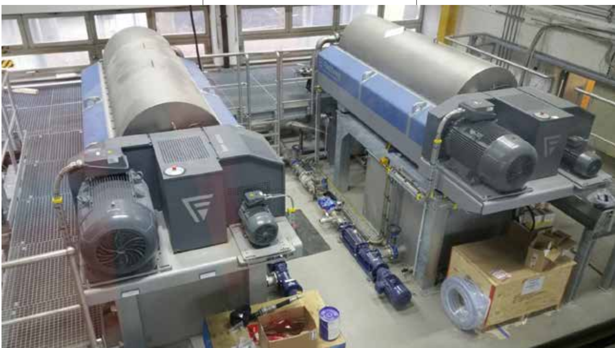
Die neuen ÜSS-Eindickzentrifugen auf der KA Soers
