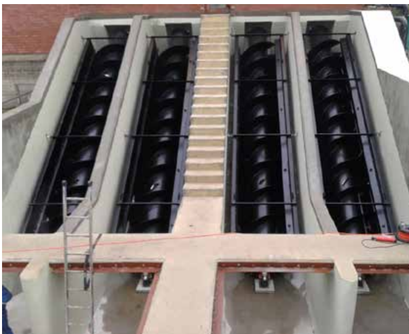
Saniertes Schnecken- pumpwerk im Zulauf der Kläranlage Eschweiler
