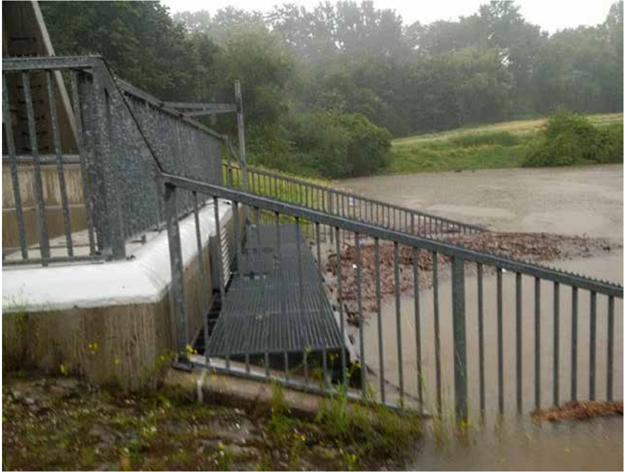
Durch ein lokales Starkregenereignis eingestautes Hochwasserrückhaltebecken Kahlgracht in Aachen-Haaren
