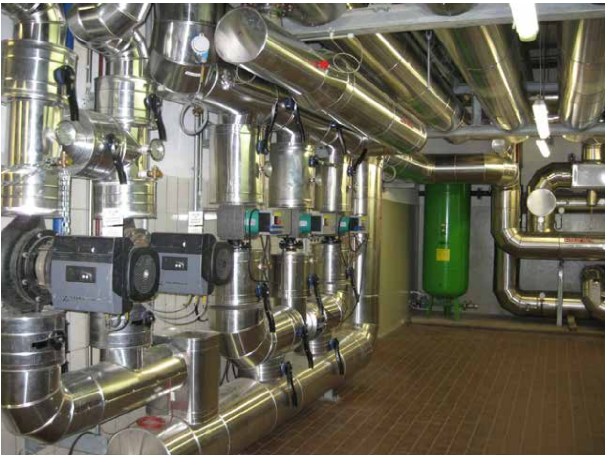
Heizwassersystem im Keller der Faulbehälter der Kläranlage Soers
