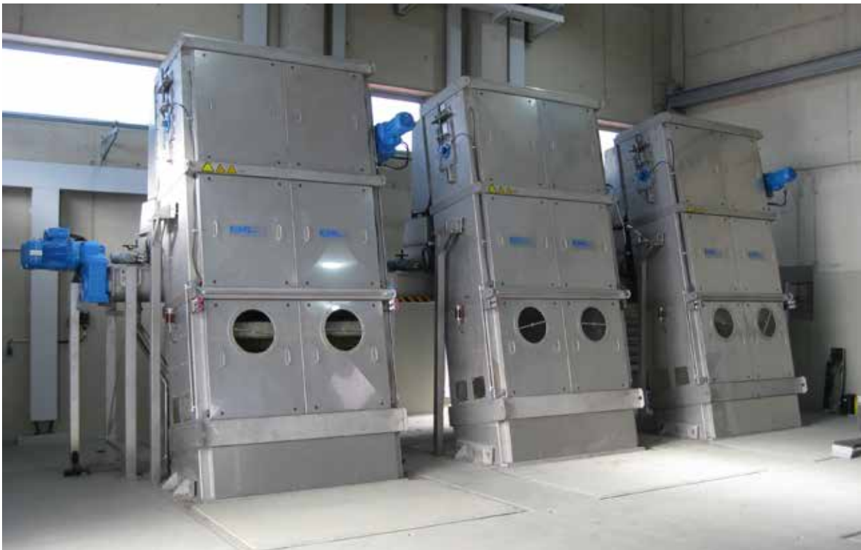
Neue Feinrechen auf der Kläranlage Soers mit einem Stababstand von 5 mm
