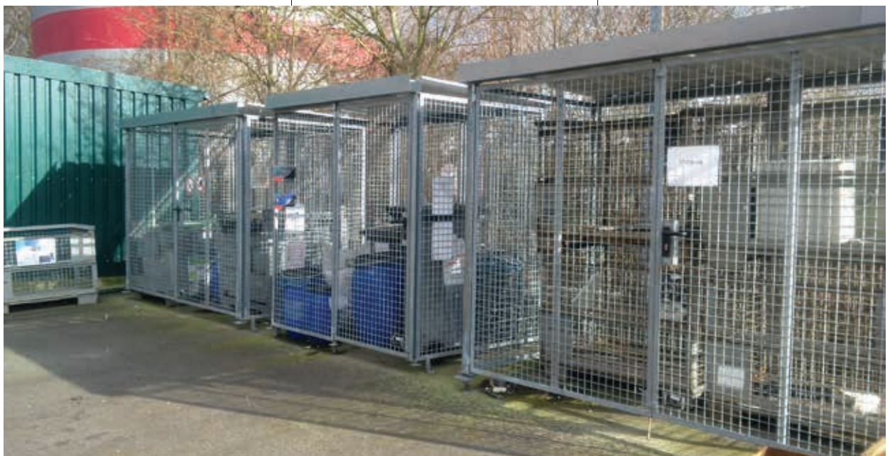
Eingehauste und überdachte Schadstoffannahmestelle auf der Kläranlage Düren
