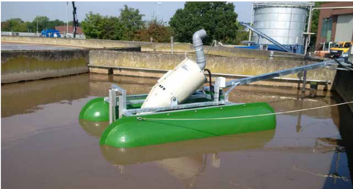
Wendelbelüfter im Einsatz auf der Kläranlage Düren
