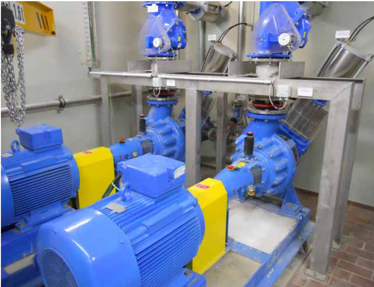
Neue Trockenwetterpumpen im Pumpwerk des Regenrückhaltebeckens am Adenauerring
