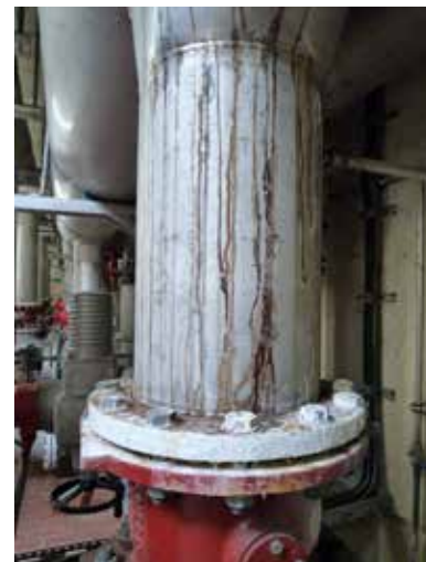
Korrodierte Edelstahlleitung der Filteranlage der Kläranlage Eilendorf
