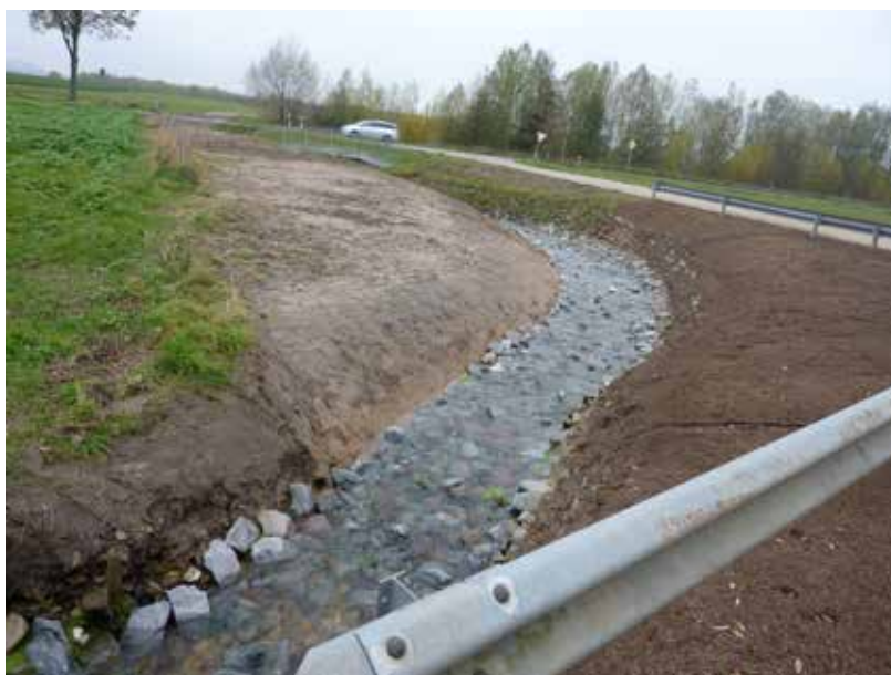
Ausgespülte und wiederhergestellte Böschung des Schaufenberger Fließes
