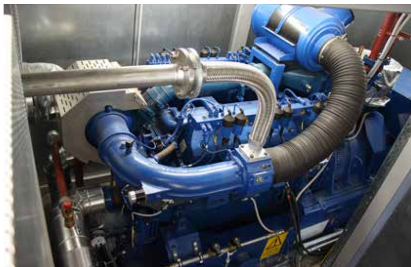
Blick auf einen der neuen BHKW-Motoren
