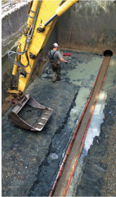
Abb. links: Sanierungsbe- dürftiges Gerinne des Abschlags- bauwerks der alten Kläranlage Nettersheim
