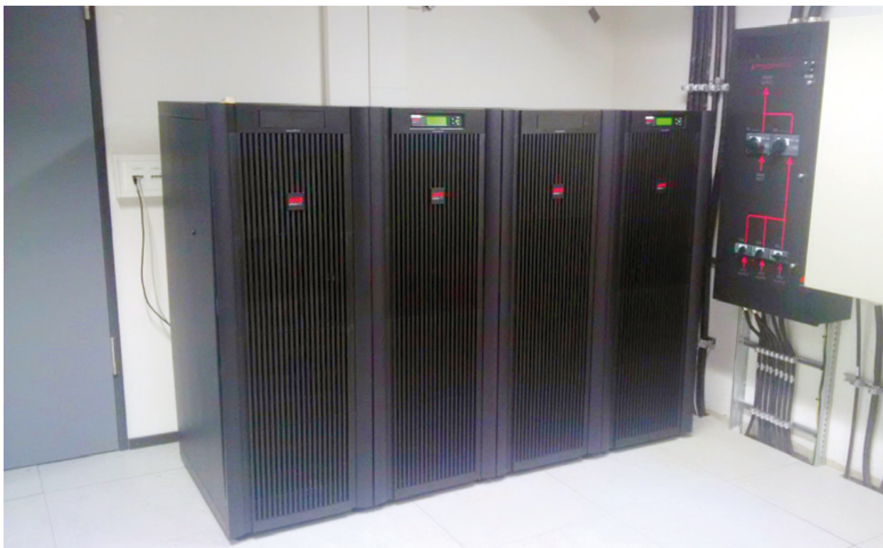
Die neue USV-Anlage
