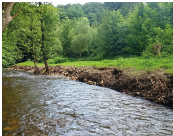
Abb. links: Die Vicht mit der schadhafte Ufermauer
